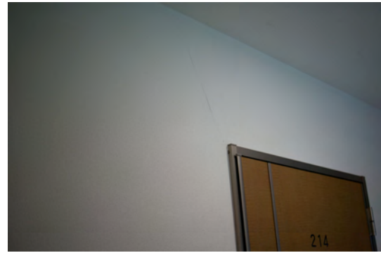
写真 16 個室入口のき裂
