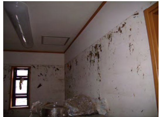
写真 21 2 階浸水レベル
