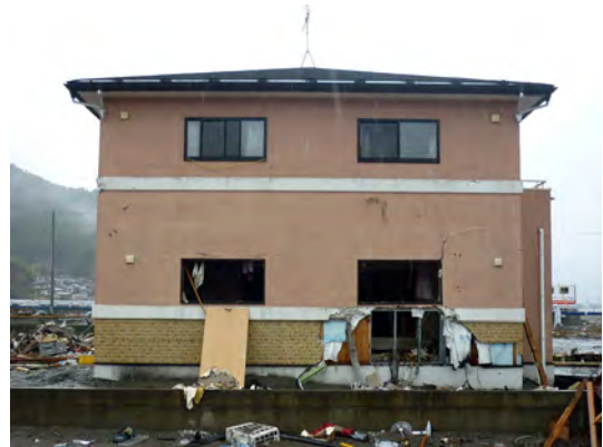
写真 25 A 棟西面 内壁・外壁大破
