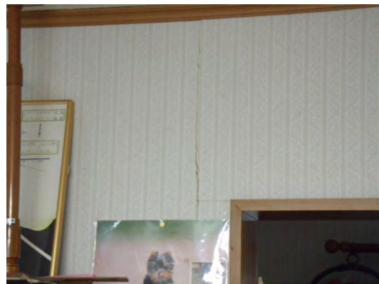
写真6 内装クロス切れ（居間）
