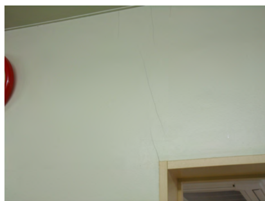
写真10 食堂厨房入口のき裂
