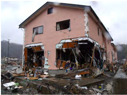
写真 22 B 棟東面 漂流物(トラック)衝突
