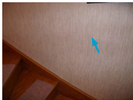
写真8 上下階での内装クロス切れ（階段室）
