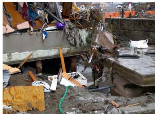
写真 27 B 棟北東角 洗掘 (写真 22 の底部)
