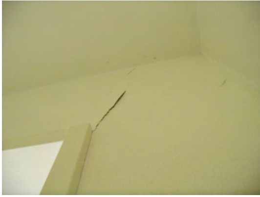
写真 15 2階トイレ入口の隅角部のき裂
