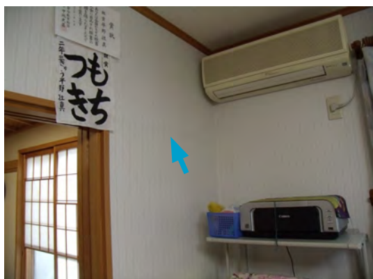
写真7 内装クロス切れ（居間）
