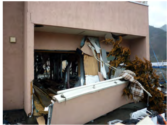
写真 23 B 棟南面東側バルコニー破損
