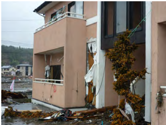
写真 24 A 棟南面西側 衝突痕
