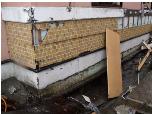
写真 26 A 棟南東角 外壁大破, 洗掘
