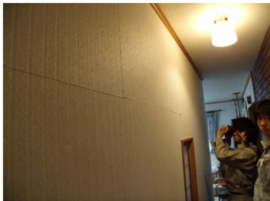
写真5 内装クロス切れ（廊下）
