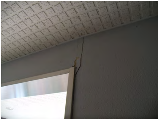
写真 17 エントランス隅角部のき裂
